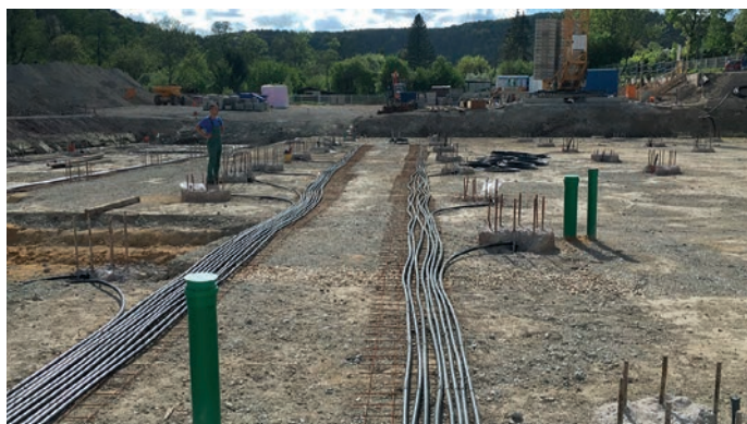
Anbindeleitungen der Energiepfähle (Fotos: BAUER Resources GmbH)
