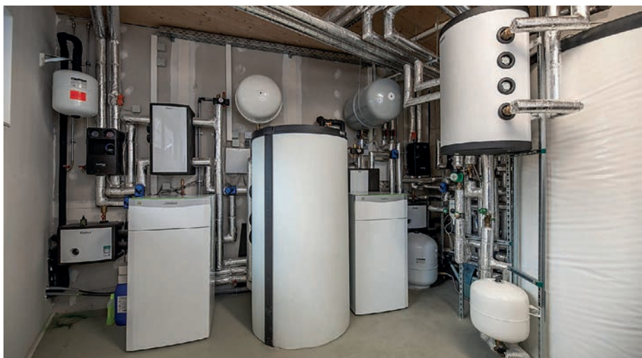
Ausgesprochen aufgeräumt präsentiert sich die Technikzentrale (Foto links). Nur an den beiden aroCOLLECT Außeneinheiten ist die regenerative Energiegewinnung für das Holzhaus zu erkennen (Foto rechts). (Foto: Vaillant/Christoph Reichelt)
