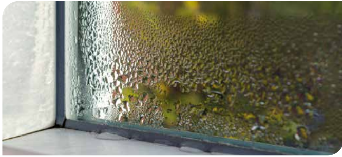
Während Türen und Fenster lange halten, werden Dichtungen weit früher spröde, härten aus oder sind mechanisch zerstört. (Foto: djd/GfA-Dichtungen/Getty Images/nadisja)
