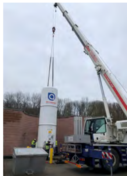
Der neue Tank wird gesetzt. Daneben sind bereits die beiden neuen Kaltvergäser zu erkennen.
