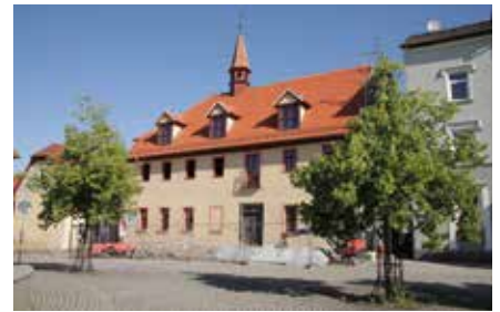
Die Außenarbeiten am Ratskeller sollen bis spätestens Ende August abgeschlossen sein. Eingang wird noch im Zuge der Arbeiten innen ertüchtigt. 🌸
