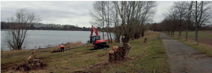
Weil sie krank sind und drohen, umzustürzen, müssen u.a. Bäume am Autobahnsee entfernt werden.
