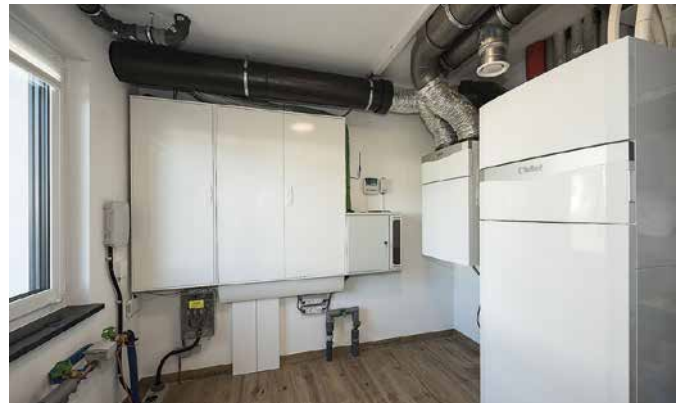
Im Haustechnikraum laufen viele technische Prozesse des Hauses zusammen.
