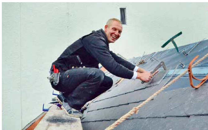
Dachdeckermeister Sebastian Hartmann hat mit seinen Kollegen in den vergangenen Wochen das Schiff der Zweenfurther Kirche fachmännisch mit Schindeln eingedeckt.
